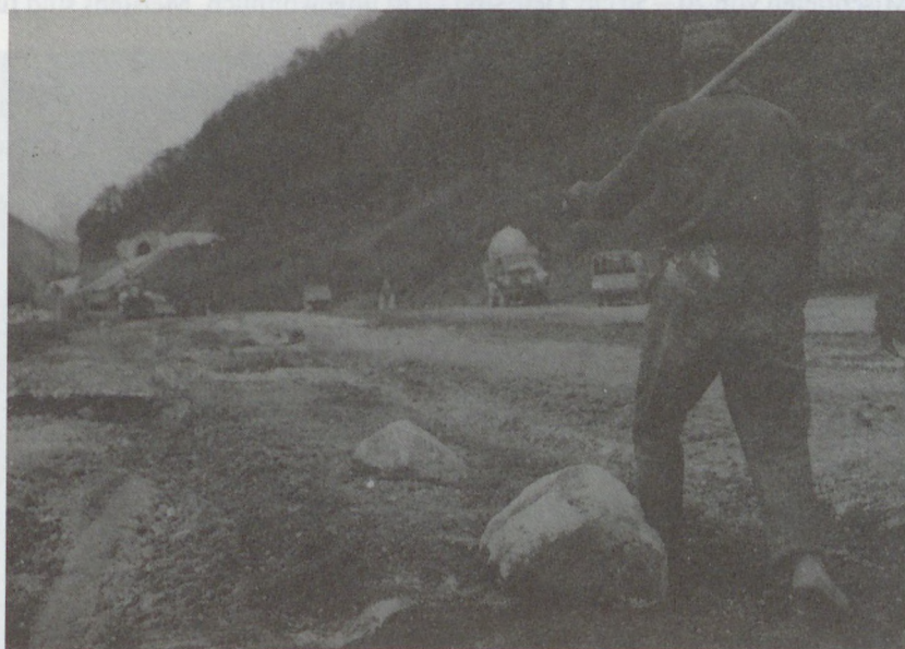
Bild 5.26 Die Verhinderung einer homogenen Einmischung des Kalkes oder Zementes wird durch solche Findlinge deutlich gezeigt. Die dunklen Farbschattierungen um den Stein herum zeigen, daß der Boden nicht mit dem Bindemittel vermischt wurde. Solche Steine gehören einfach nicht in die Schüttung
