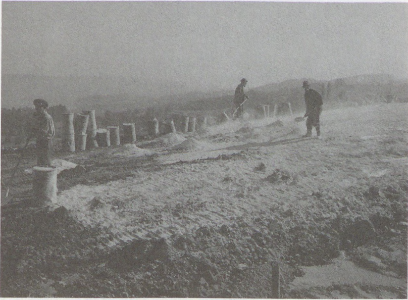
Bild 4.27 Die Verteilung des Kalkes von Hand ist unrationell, und es besteht eine hohe Unfallgefahr. Der Arbeiter links vorne im Bild hat trotz Ermahnungen Mundschutz und Brille abgelegt
