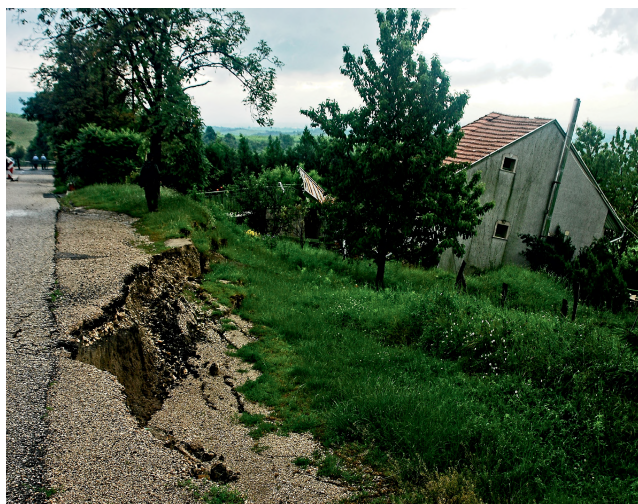
A 2010 májusában történt dunaszentmiklósi csuszamlás szakadási fala és a megcsúszott lejtő felső szakasza (CsG)
