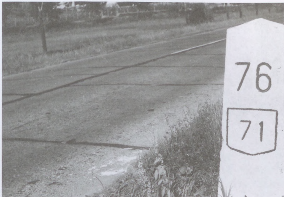
30.7. fénykép. A 71-es betonburkolatát a 76+000 km szelvényben 1940-43. évek között betonozták. A betonfelület állapota igen jó [Liptay (1972)]
