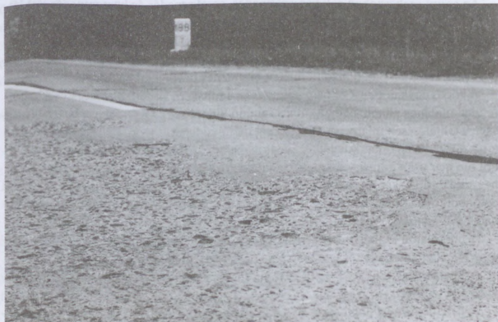
30.9. fénykép. A 7-es út 188+030 km szelvényében a felület sérülése a felső, még le nem kopott habarcsréteg leválásával kezdődött [Liptay (1972)]
