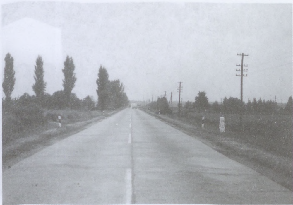
30.8. fénykép. A 6-os út betonburkolata a 78+000 km szelvényben. 1949-ben építették. A képen az egyenlőtlen kopás figyelhető meg [Liptay (1972)]
