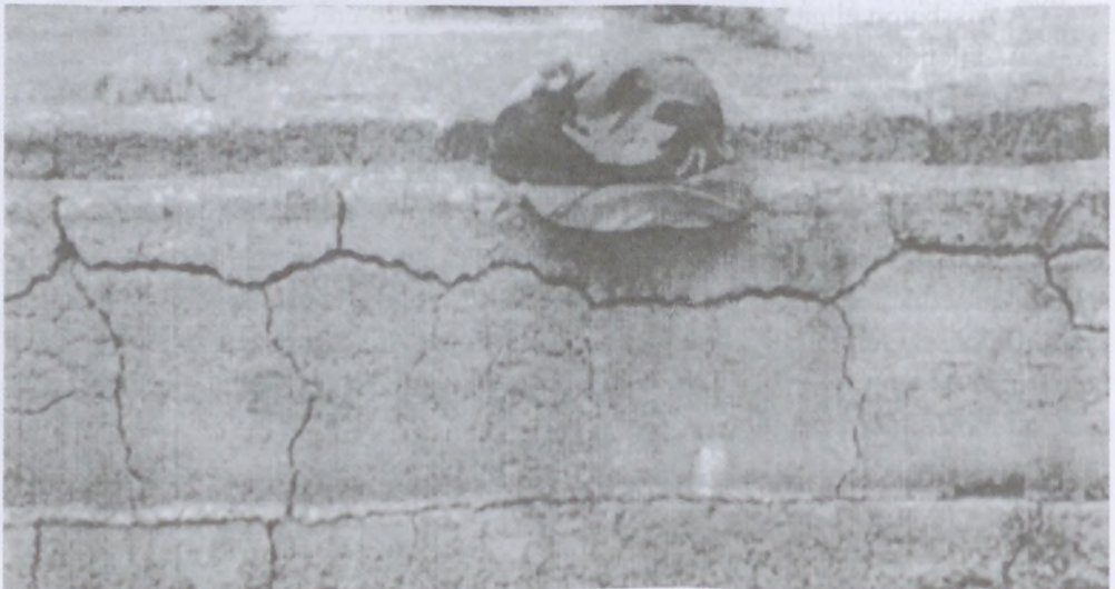
27.1. fénykép. Adalékanyag-alkáli reakció okozta repedések betonfalon [Révay (2004)]
