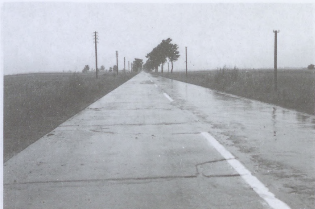
30.6. fénykép. Az 52-es út betonburkolata a 40+000 km szelvényben. A kép jobb oldalán a betonfelületet bitumenes bevonással javították [Liptay (1972)]
