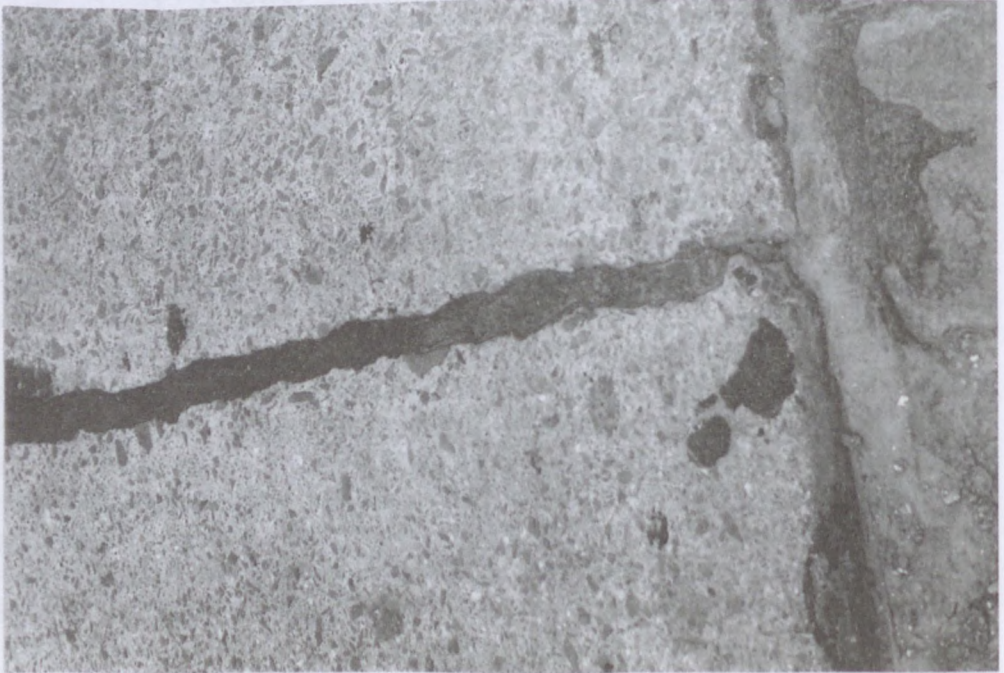
30.3. fénykép. A 10-es út betonfelülete az 50+200 km szelvényben a hézag mellett, a kép jobb oldalán a betont 1927-ben, bal oldalán pedig 1930-ban építették [Liptay (1972)]
