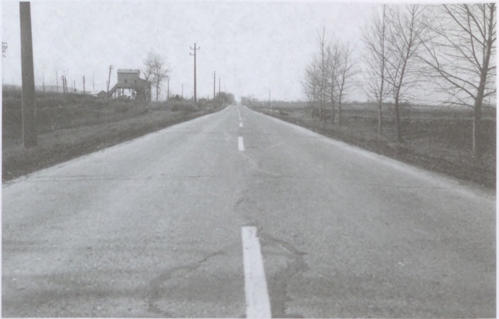
30.1. fénykép. A 10-es út betonburkolatának felületi állapota a 48+000 km szelvényben 1972-ben. Építés éve: 1927 [Liptay (1972)]
