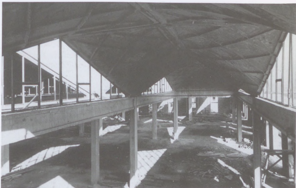
16.92. ábra. Pécsi gépkocsiforgalmi telep csarnokának a lefedése előre gyártott héjelemekkel. a) Az előre gyártott elem vasalása, b) megépített héjszerkezet belülről (Fotó: UVATERV fotólaboratóriuma, Löbné Szidon Mária)
