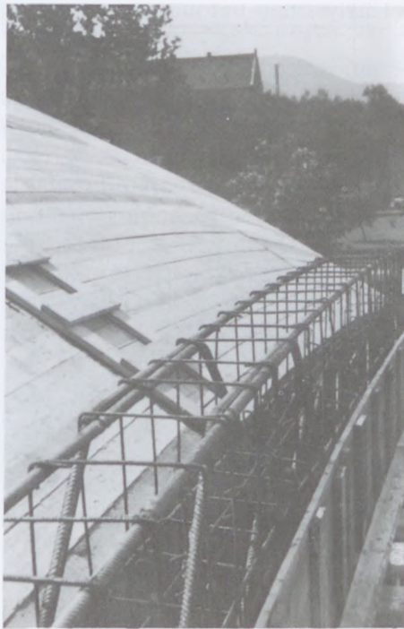
15.152. ábra. A VTSK kétpályás fedett teniszstadion: a) alaprajz; b) keresztmetszet; c) előnézet; d) építés közben [Füzy J. (1965)]
