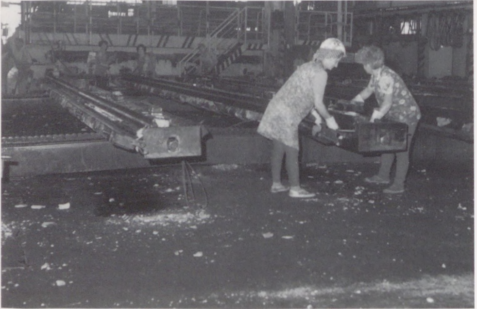
6.17. ábra. E-jelű födémgerenda gyártása az Alsószolcai Vasbetonipari V.-nál, az ikersablon nyitott állapotban (Fotó: Ozvári György)
