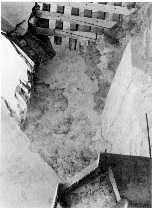
55. A falpillér fejezetére támaszkodó kőbordás boltozat homlokíve mentén kiforduló vakolat rövid szakasza
