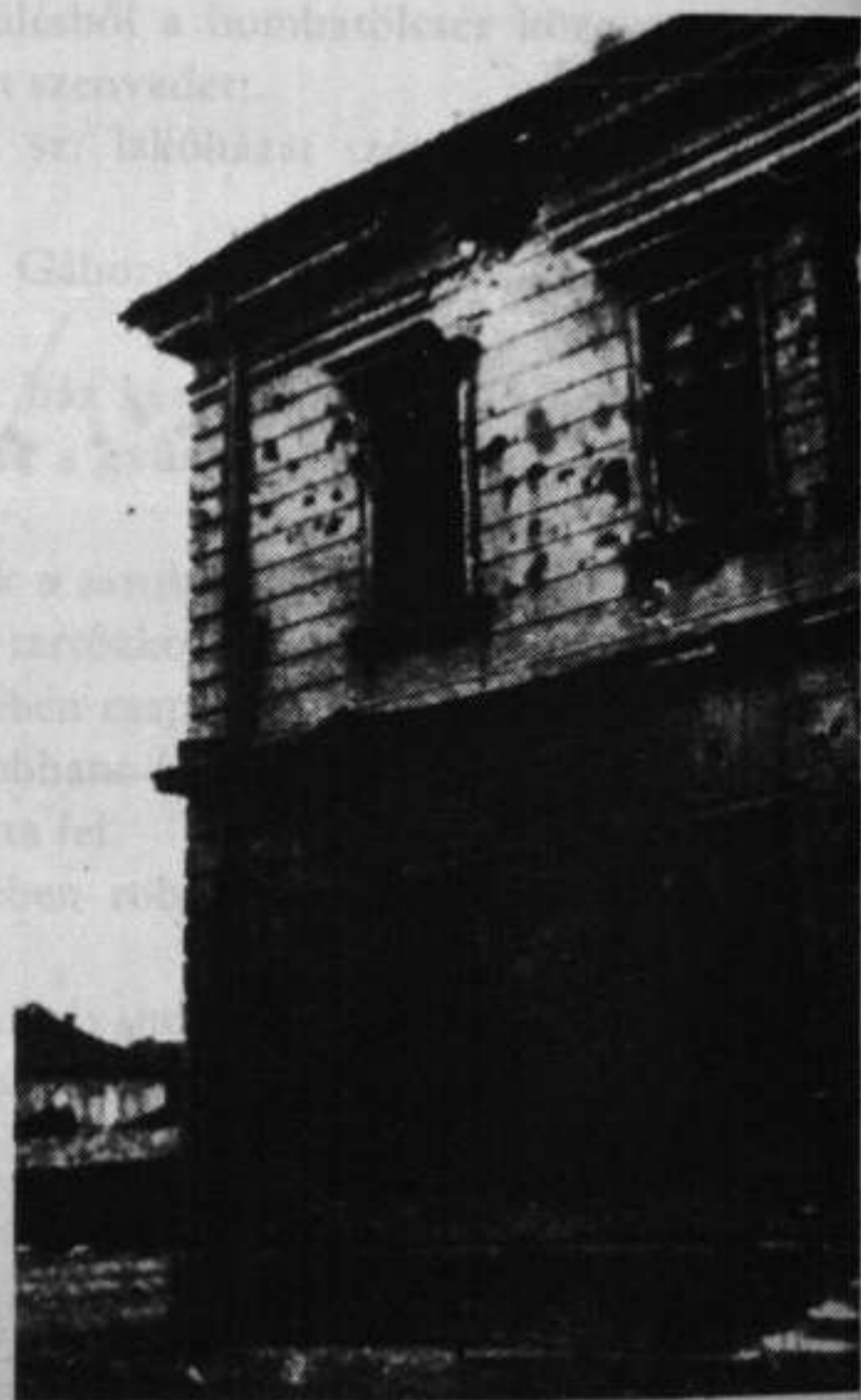
8. ábra. A 8. sz. bomba rombolása. 23. táb. tűzérosz épületének nyugati falán a repeszhatás, tetőfedésénél bomba becsapódási nyílása és a parkány rongálódása.
