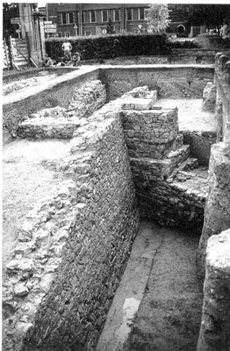
Abb. 11. Freigelegtes Teilstück der stadtseitigen Futtermauer des barocken Schloßgrabens. Aufnahme: BDA, F. Sauer.
