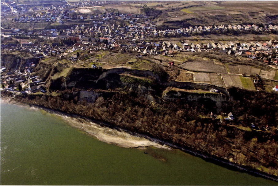
51. kép. A partfal 300 m hosszúságú, a Dunába szeletes földcsuszamlással leomlott része, amely a partszakaszon a Duna medret is felgyűrve a folyam sodorvonalát is megváltoztatta. Fotó: OSZVALD T. 2008.
