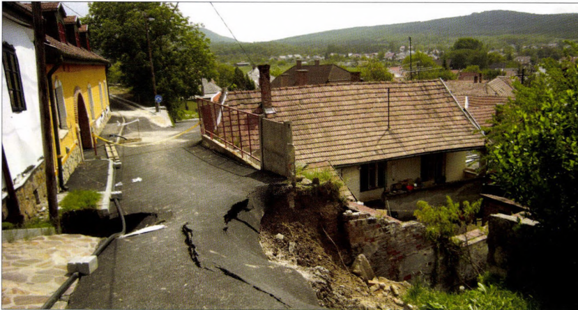
71. kép. Falomlás következtében kialakult útkár Piliscsévben. Fotó: OSZVALD T. 2006.
