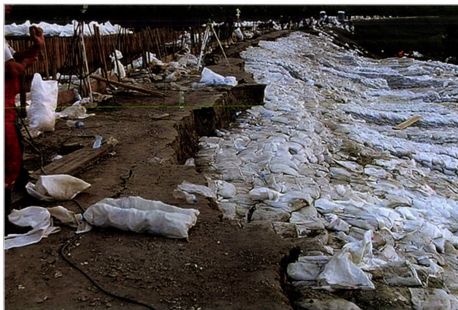
15. kép. 2006-ban Szelevény mellett a Tiszazugban katasztrófa közeli rézsúcsúszás alakult ki, amit a Katasztrófavédelem irányításával a helyi lakosság emberfeletti munkával hártott el. Fotó: SCHWEITZER F.
