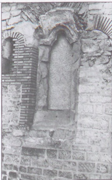
Rekonstruált román kori ablakok a déli „tanúfalon” – Rekonstruierte romanische Fenster an der südlichen „Schichtwand”
