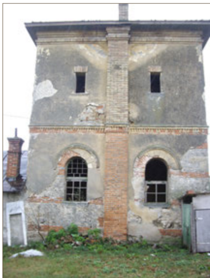
123. kép. Rakasdia állomás. A romos víztorony 2013-ban
